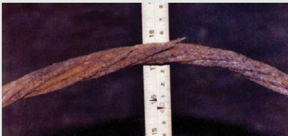
Figura 5 – situação de um cabo após o teste e o conseqüente remanejamento: constatação de comprometimento e imediata substituição.
