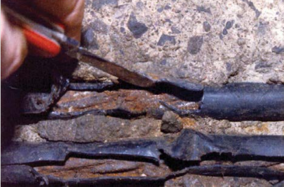
Figura 6 – muita umidade no teste e a constatação do problema.
