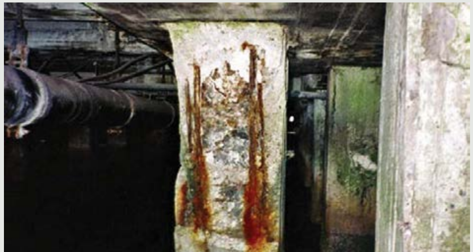
Figura 5 - Estaca de concreto sem proteção catódica (JAQUETA G).
