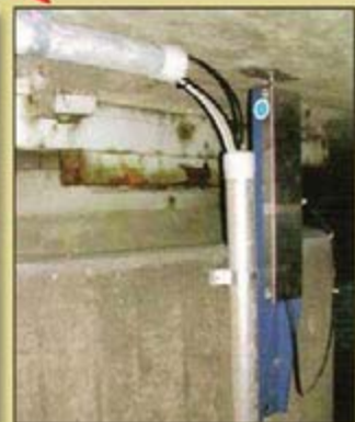
Cabeamento ótico próximo ao apoio.
