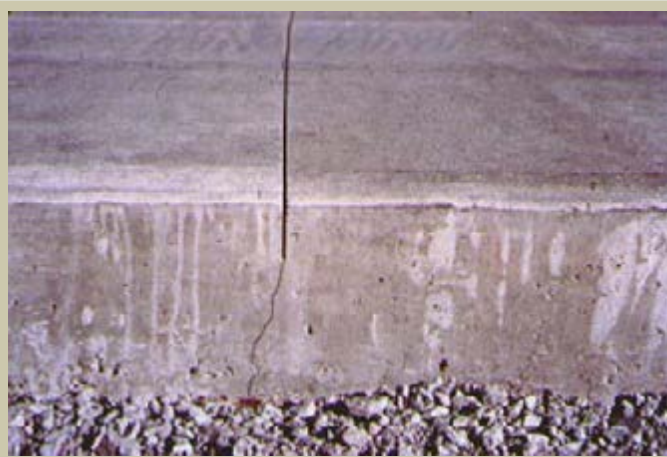
Junta de controle: repare a trinca induzida pelo corte.
