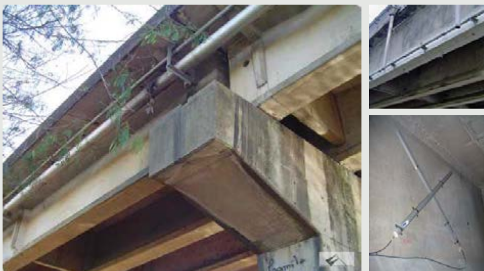
Sensores (cabos ópticos) posicionados na região de máximo cisalhamento, perpendicular às micro fissuras existentes nas vigas deste viaduto em concreto protendido.
