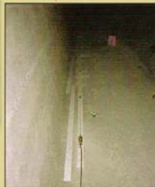
Cabo ótico (sensor) dentro da viga caixão.
