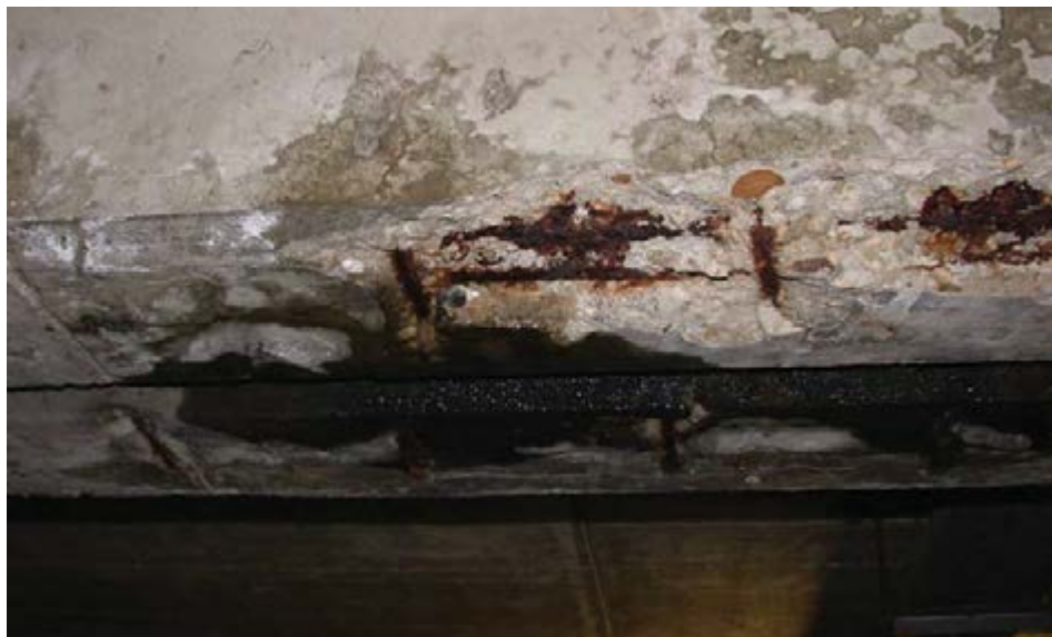
Exemplo de corrosão de armaduras do concreto induzido por sais cloretos no teto da garagem de um grande condomínio a beira mar.
